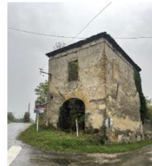
Élément non cadastré en partie ruiné (toiture) (1)
