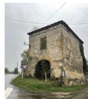
Élément non cadastré en partie ruiné (toiture) (1)
