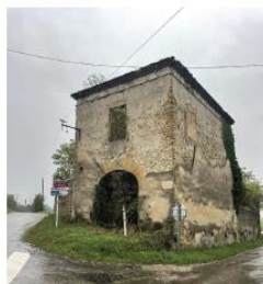
Élément non cadastré en partie ruiné (toiture) (1)
