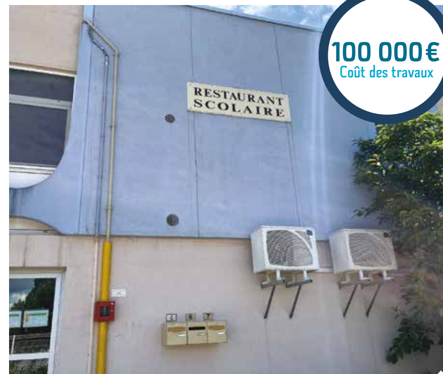
Climatiseurs installés au restaurant scolaire.
